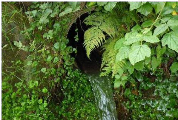
Abbildung 48: Krebs Sperre mit funktionaler Einschränkung auf Grund der Sukzession der Ufervegetation. Aufwärtswandernde NICS können über die Pflanzen in den Rohrdurchlass klettern oder die Sperre über Land umwandern. (Foto: B. Schmieder)
