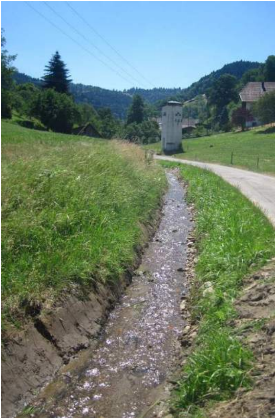
Abbildung 23: Zustand nach Grabenräumung eines kleinen Mittelgebirgsbaches in Baden-Württemberg, der die Funktion eines Wegseitengrabens erfüllt. Vermutlich erfolgte die Maßnahme, um den Abflussquerschnitt freizuhalten. Kurz zuvor wurde durch Kartierung ein individuenreicher Bestand von A. torrentium im Gewässer belegt. Es ist von einer erheblichen Beeinträchtigung der Population auszugehen, da bei der Räumung auch in die Sohle des Gewässers eingegriffen wurde (Pfeiffer, 2019, mündliche Mitteilung). (Foto: M. Pfeiffer)
