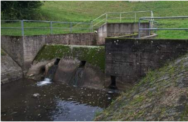
Abbildung 43: Auslaufbauwerk eines Hochwasserrückhaltebeckens im Dauerstau vor der Modifizierung zur Krebs Sperre. (Foto: R. Hennings)
