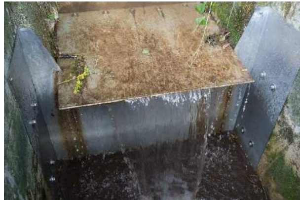
Abbildung 38: Detailansicht der Verblechung mit Überkragung des Absturzes und Teilverkleidung der Wände. (Foto: Verfasser)
