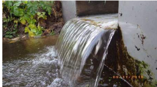
Abbildung 47: Detailansicht des Absturzes. (Foto: W. Rötter)
