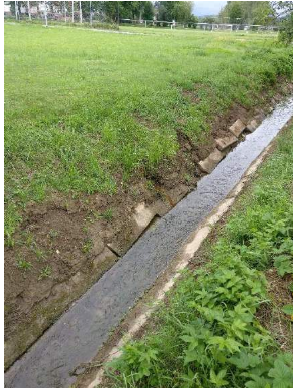
Abbildung 22: Kleines Fließgewässer am Rande einer Ortschaft in Baden-Württemberg mit Bestand von A. torrentium (und einwanderndem P. leniusculus ). Schäden an der Sohl- und Uferbefestigung haben Spalten und Hohlräume entstehen lassen, die von Flusskrebsen besiedelt werden. Eine Sanierung der Schäden wie eine Renaturierung könnte hier erhebliche negative Folgen auf die Population haben. (Foto: Verfasser).
