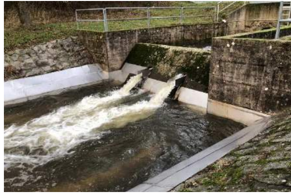
Abbildung 44: Auslaufbauwerk nach Einbau der Verblechung. Rundum wurden Edelstahlbleche angebracht, um NICS am Verlassen des Tosbeckens zu hindern. Die beiden Auslaufscharten wurden ausgeblecht und mit einer Überkragung versehen, damit ein Absturz entsteht und der Wasserstrahl abgelöst wird. Auftretendes Bio-Fouling wird regelmäßig mit einem Hochdruckreiniger entfernt (Hennings, 2019, schriftliche Mitteilung). Träger der Maßnahme war der Gewässerverband Bergstraße, eine Finanzierung erfolgte aus Landesmitteln des Naturschutzes (Heinz, 2019b, schriftliche Mitteilung). (Foto: R. Hennings)
