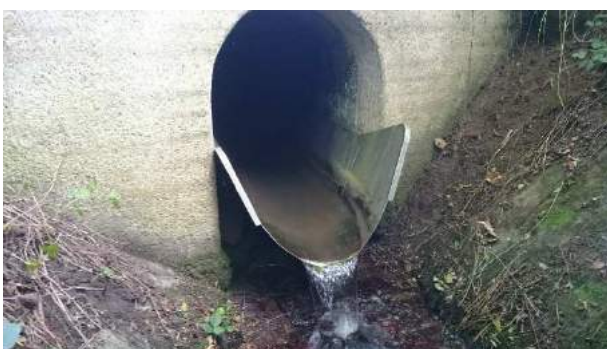
Abbildung 42: Teilverblechung eines Durchlasses zur Erzeugung eines Absturzes und als Schutz vor seitlichem Einklettern. (Foto: C. Günter)
